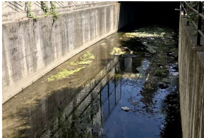
Şekil 5.7 Hacet Deresi'nde Oluşan Yosunlaşma ve Kirlilik
